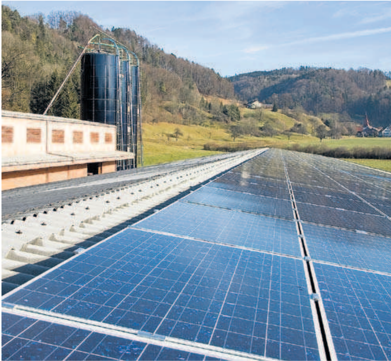
Der Stadtrat will in den nächsten Jahren 90 Millionen Franken in erneuerbare Energien investieren. Nur ein kleiner Teil davon wird in lokale Projekte fliessen wie diese Solaranlage auf dem Dach des städtischen Bauernhofs Ifang bei Rikon. Bild: pd
